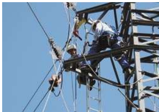
Manutenzione in Sardegna della rete elettrica di Terna spa
